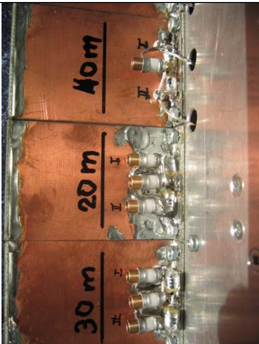
Abbildung 9: Filter von der Schwingkreisseite aus gesehen – Detailaufnahme
