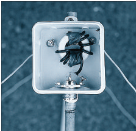
Bild 6: Der Anschlusskasten mit dem Balun
