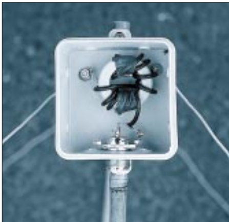
Bild 6: Der Anschlußkasten mit dem Balun
